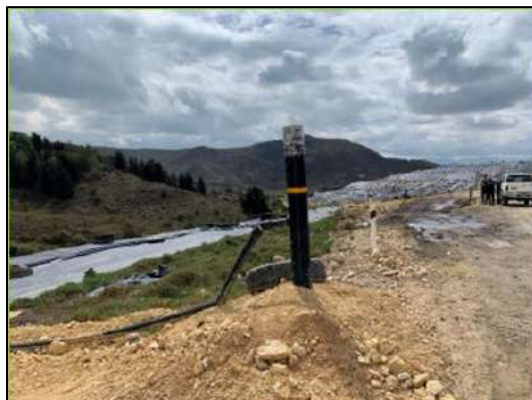
Foto 9. Sistema de captación de biogás
