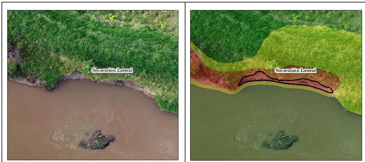
Ilustración 24. Proceso de socavación lateral sobre los taludes del dique sobre el río Bogotá. Coordenadas: X=1007406,9 Y=1036079,8 MCB
