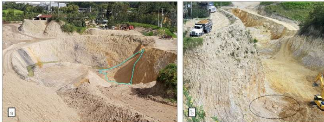
Ilustración 12. Cantera, en la vía Cajicá-Tabio límite municipal al sur occidente de Cajicá, a) coluviones provocados de forma controlada para la extracción del material de construcción, b) fragmentos de roca que han cedido a la fuerte pendiente y la gravedad, estación 20 (X: 4881817,74 Y: 2102239,6).
