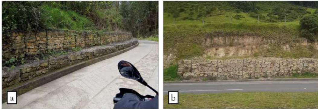
Ilustración 6. Depósitos Coluviales y fluviotorrenciales que pueden llegar a ser potencialmente inestable; a) en la vereda Chuntame, cerca al Mirador la Cumbre, estación 004 (X: 4885232,44 Y: 2108792,98), b) Gavión de contención para suelos transportados fluviotorrenciales, sobre la vía Cajicá – Zipaquirá, estación 014 (X: 4888757,46 Y: 2,104,895.72).
